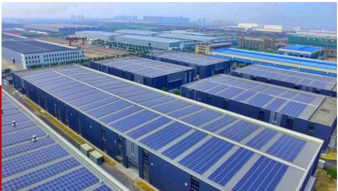
临港奉贤园区屋顶光伏电站
